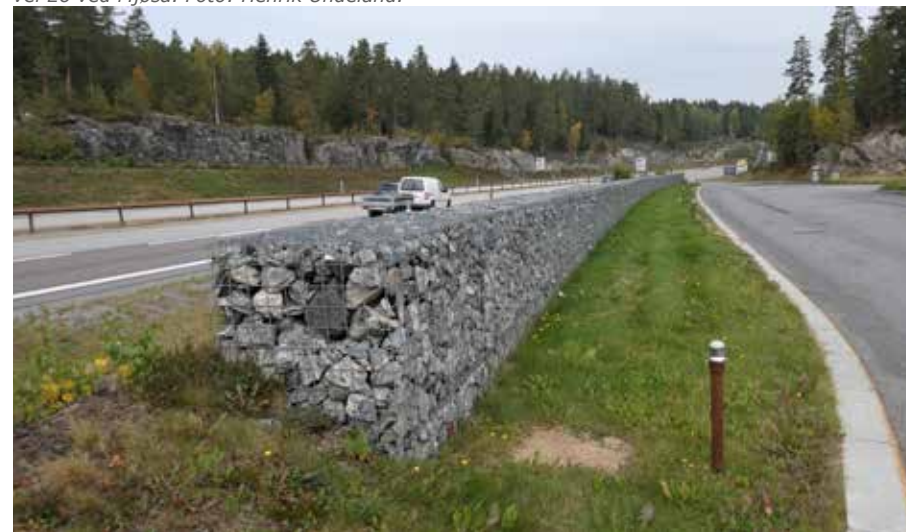
Fig. 3.17: Eksempel på en lav støyskerm av gabioner på rasteplassen Andelva ved siden av E6. Foto: Henrik Undeland.
