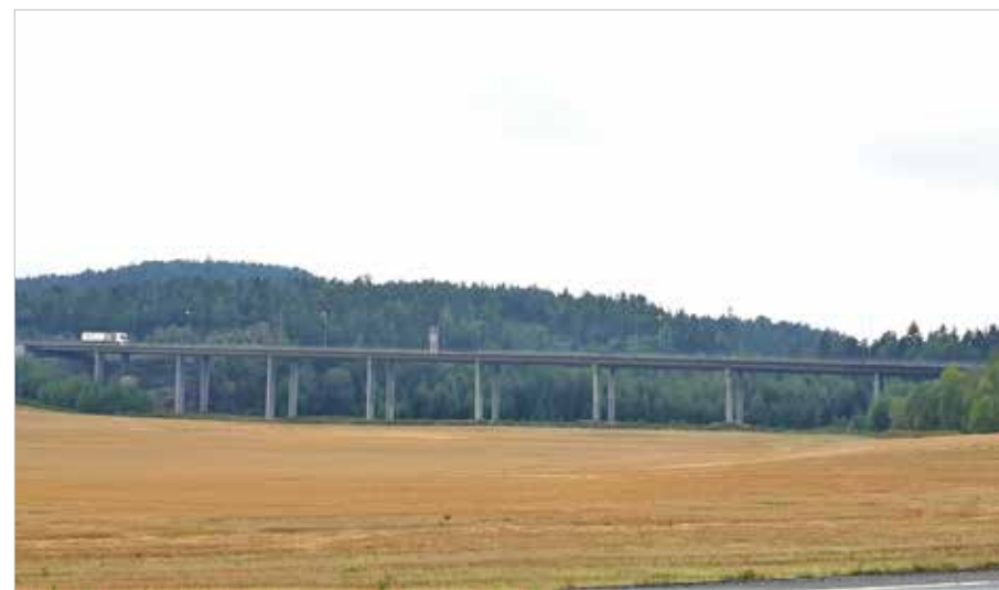
Fig. 5.11: Broer i veilinjen bør normalt utføres som enkle diskrete konstruksjoner i landskapet, som her E6 over en dal vest for Halden. Foto: Henrik Undeland.
