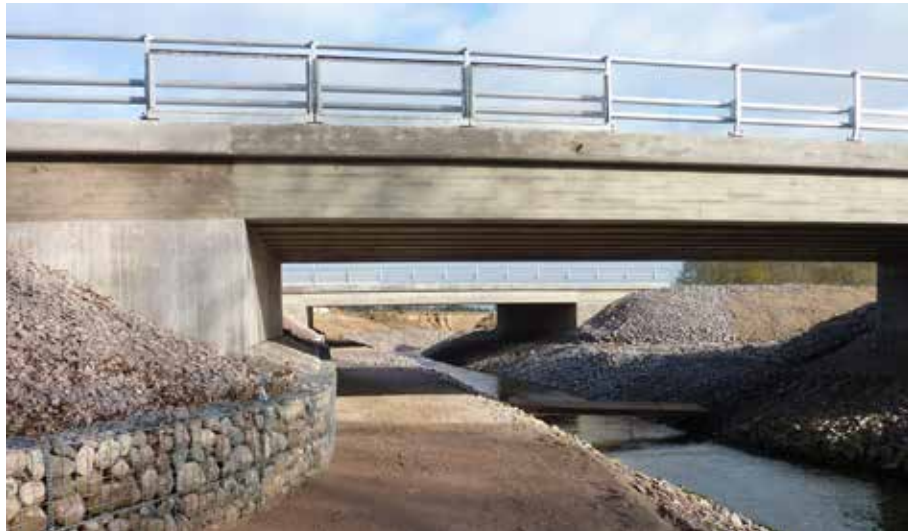
Fig. 5.14: Udergang med utforming som et lyst rom for de som passerer under vei 50 ved Skänninge i Sverige I tillegg gis de en god visuell kontakt med vassdraget selv om vassdraget selv kunne ha vært utformet med mer vegetasjon.. Foto: Henrik Undeland.
