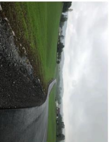
Figur 2: Første vekstsesong. Asfaltert anleggsveg med duk som går helt ut til siden.
