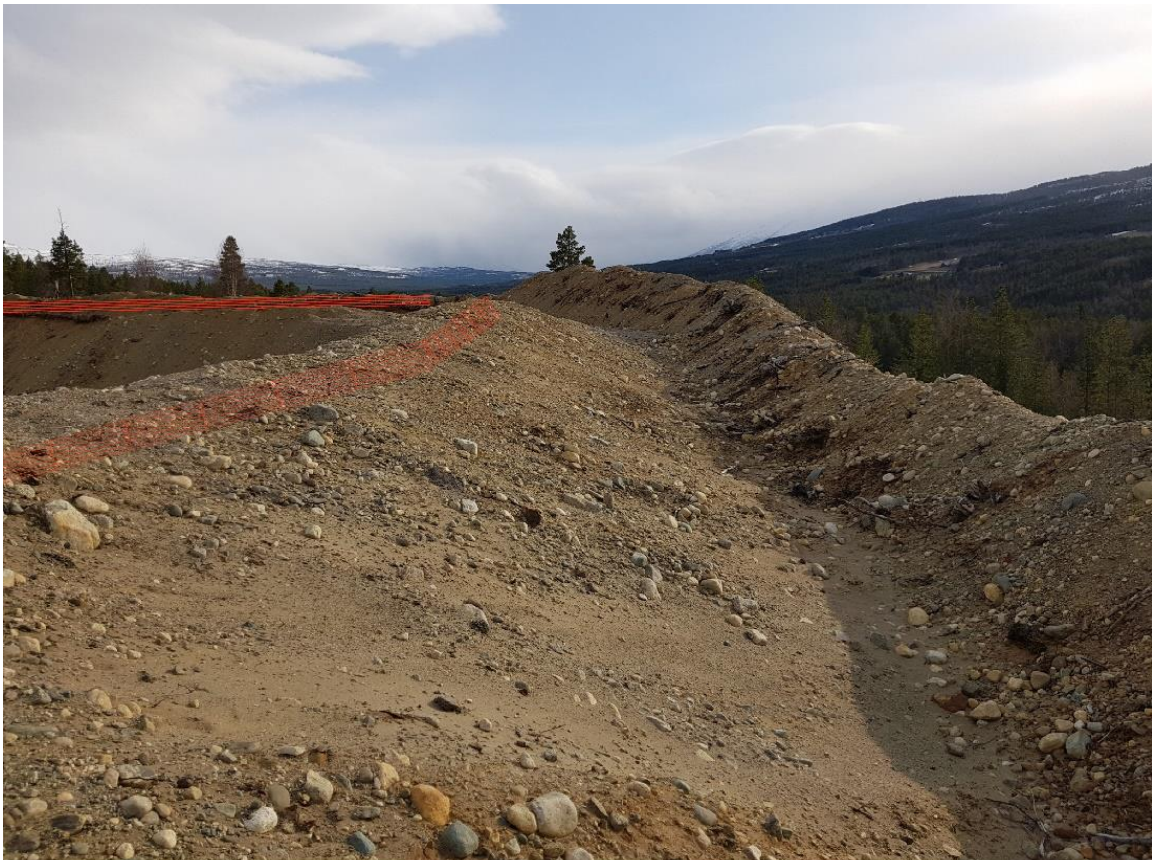
Fig. 4: Viser sperregjerder langs uttaksskråningene.
