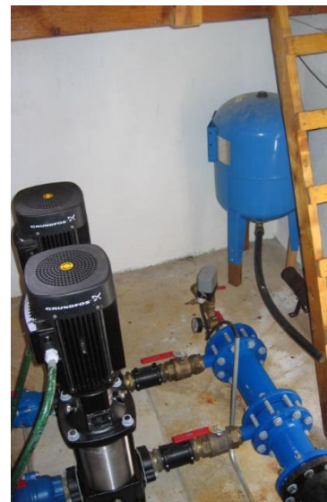
Figur 7: Granliveien pumpestasjon (Foto: Rennebu kommune)
