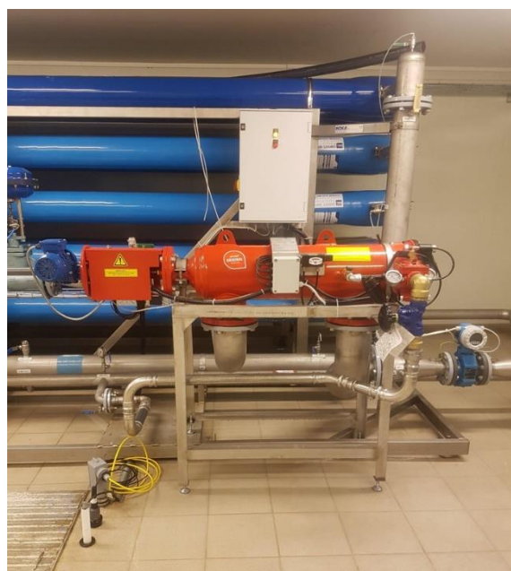
Figur 6: Gruva vannbehandlingsanlegg (Foto: Rennebu kommune)
